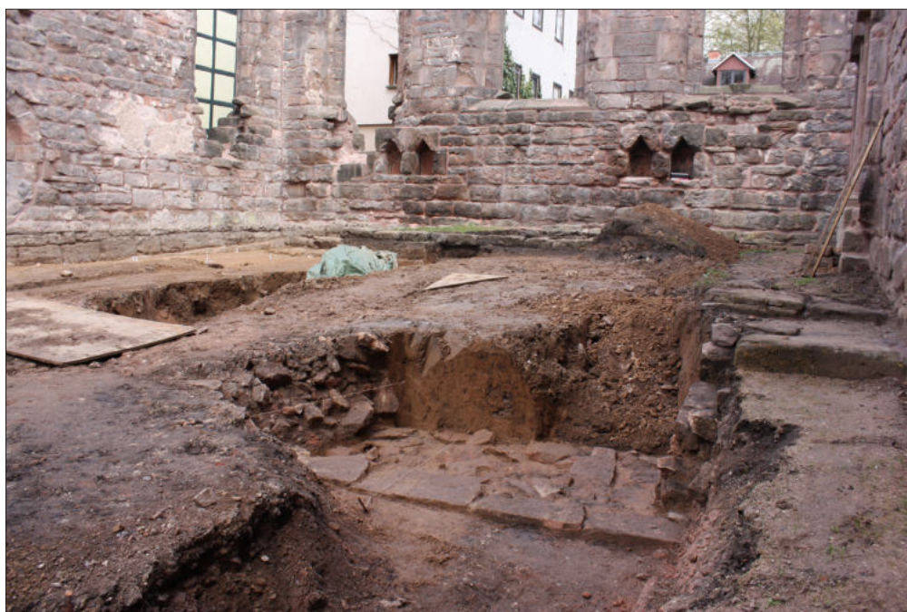
Abb. 8. Im Chor der Klosterkirche Stadtroda, Saale-Holzland-Kreis, konnte ein 1,35 m breites Fundament aus Sandsteinen freigelegt werden, das als Unterbau einer Chorschranke gedeutet wird (Foto: Ulrike Meister).
